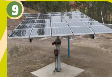
9. Une centrale solaire
